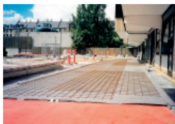
Enkadrain använt ovanpå ett parkeringshus.
