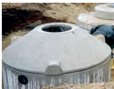
Runde prefabrikkerte tanker
